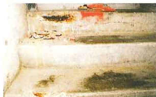
劣化、ひび割れ、汚れのひどいコンクリート
